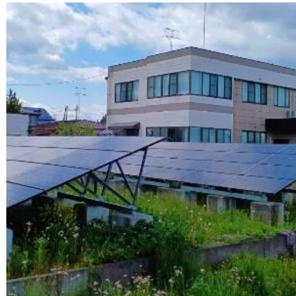
太陽光発電設備
